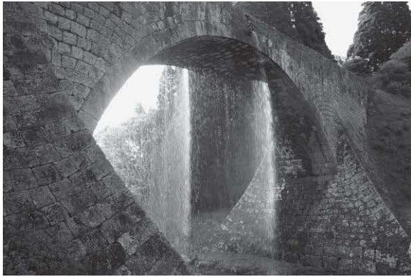
(a) アーチ輪石からの漏水
