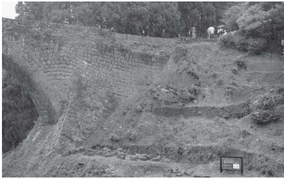
(a) 大雨で崩壊した壁石の状況
