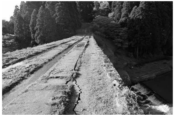
写真3-1-3. 被覆土の地割れ
