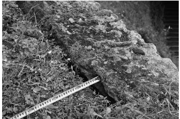
写真3-1-2. 手摺石の孕み出し
