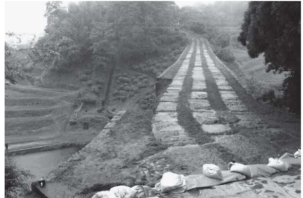
写真4-1-1. 崩落部橋上面
