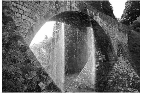
写真3-1-1. アーチ下端からの漏水
