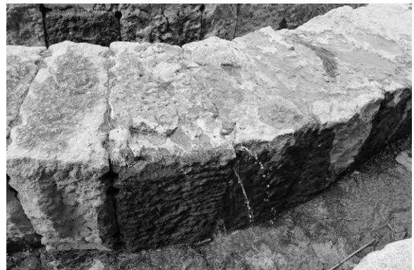
写真31. 通水試験で漏水した通水石管
