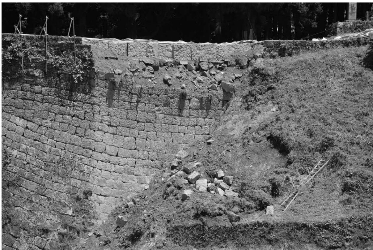
写真42. 石垣崩落箇所（平成30年5月）
