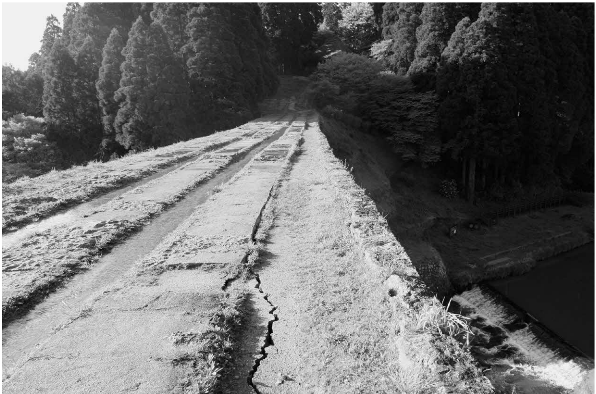
写真16. 手摺石孕み出しと被覆土の亀裂（平成28年4月）
