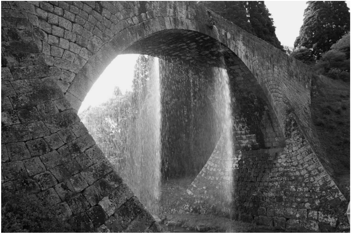
写真15. アーチ下端からの漏水（平成28年4月）
