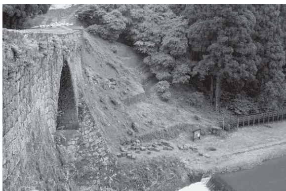
写真44. 崩落石材全景
