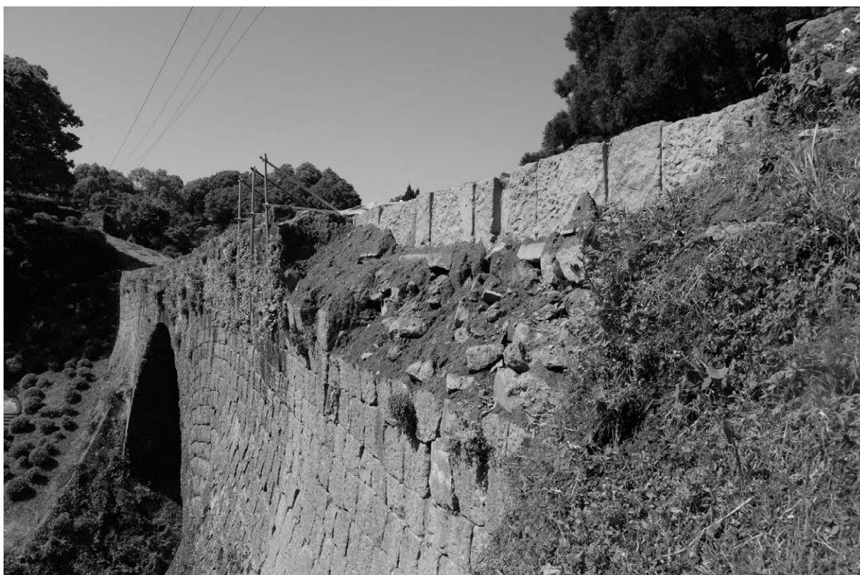
写真43. 石垣崩落箇所近景（平成30年5月）
