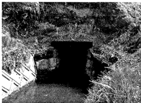
図 (Fig) 25 水面が縮小する水路トンネルの状況
