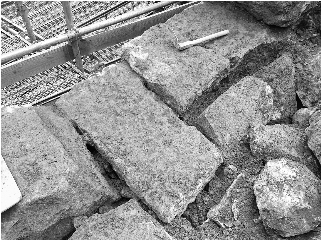
写真46 通潤橋 壁石にみられる長尺の石材②（令和元年（平成31年度）保存修理工事 / 裏築解体時）
