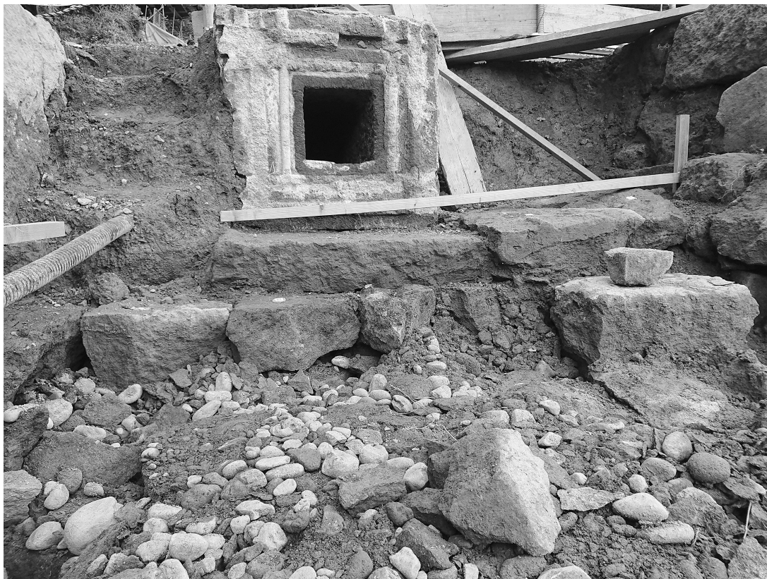
写真39 通潤橋 通水石管・敷石・裏築天端石・円礫の層序（令和元年（平成31年度）保存修理工事）
