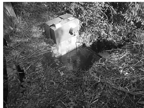
図5-3-30 隅角部に設置された自動転倒式ゲート
