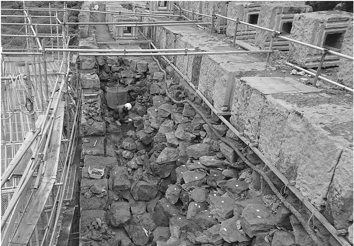
写真42 通潤橋 裏築と壁石（築石）②（令和元年（平成31年度）保存修理工事 / 裏築解体時）
