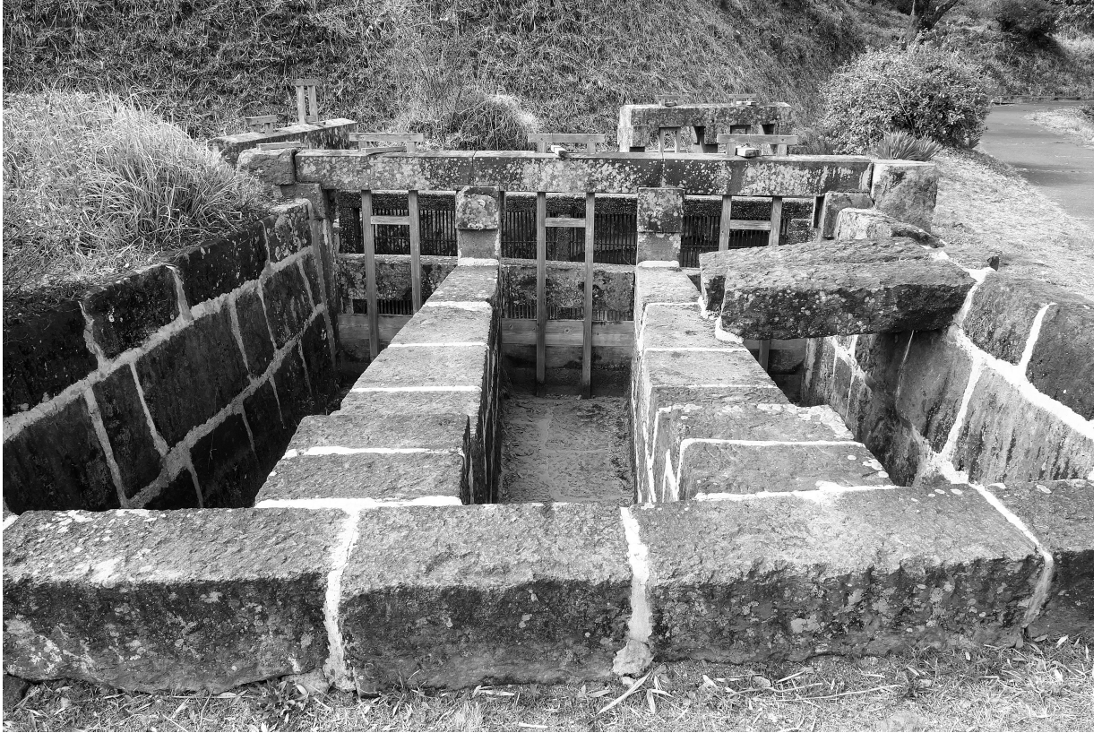
写真49 通潤橋取入口 近景② (通水石管 (吹上樋) 接続部より本井手通り砂蓋を望む)
