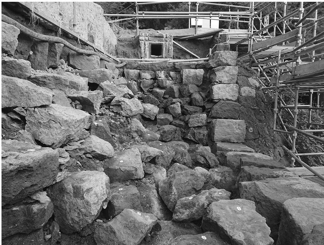
写真43 通潤橋 裏築と壁石（築石）③（令和元年（平成31年度）保存修理工事 / 裏築解体時）
