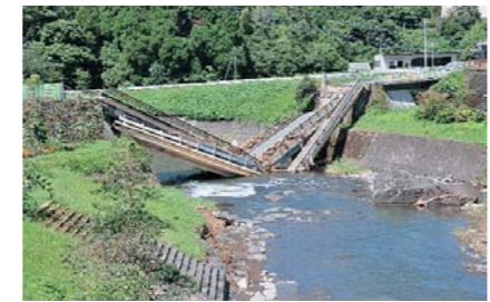
落橋した金内橋
