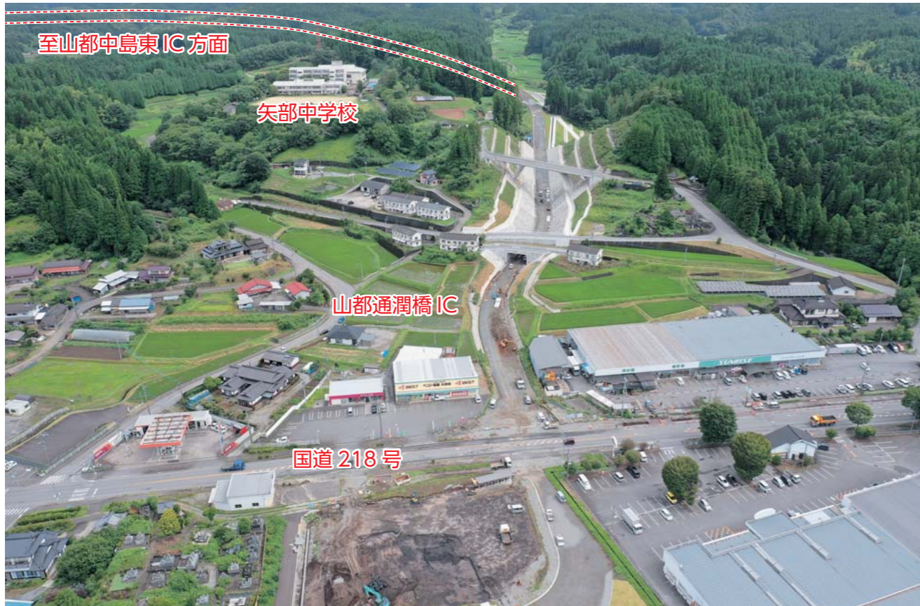
山都町城平地区国道 218 号交差点部工事状況 (令和 5 年 6 月末時点)
