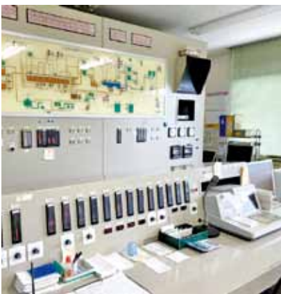
千滝クリーンハウスの制御室
