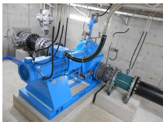
小水力発電 (戸島送水場)
