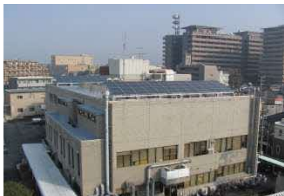
太陽光発電 (上下水道局別館)
