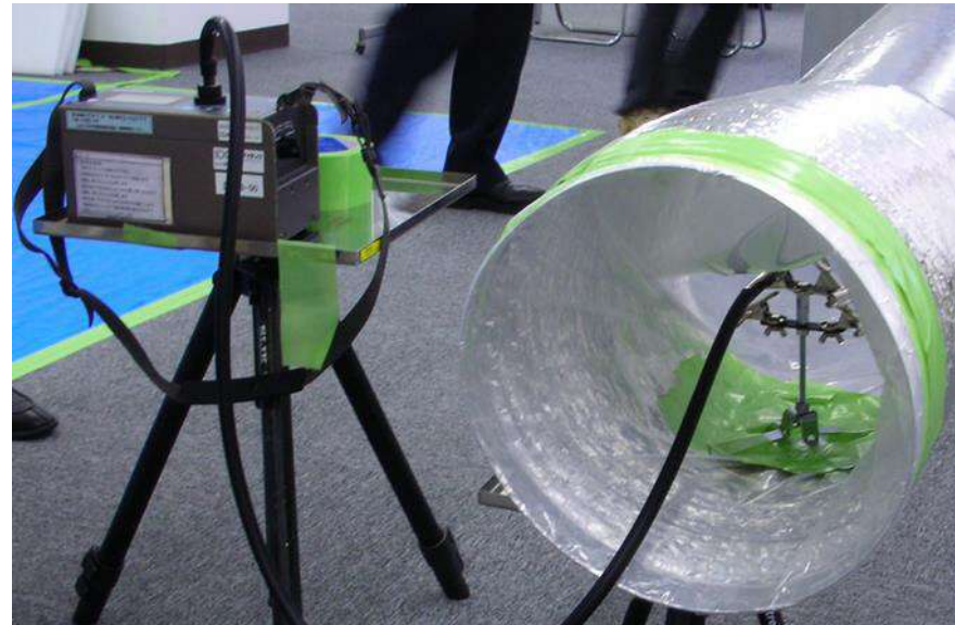
②集じん・排気装置が正常に稼働していることの確認方法の例(粉じん計による確認)
