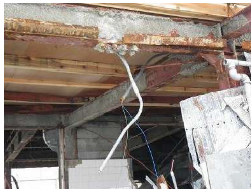
建物に残存した吹付け材
