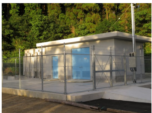
今村送水ポンプ場
