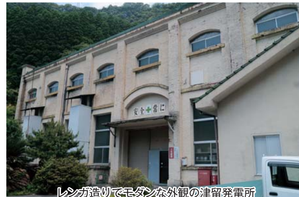
レンガ造りでモダンな外観の津留発電所 熊本地震の際、外壁に亀裂等が入るも、崩落等の大きな損壊はなかった。
