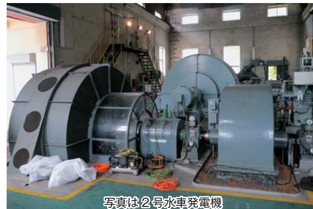
写真は2号水車発電機 右から左に床下を水が流れ、右側の水車をまわし、左側の発電機で発電する。
