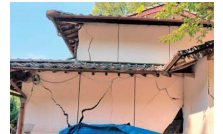
地震の影響により、外壁に亀裂が発生している様子
