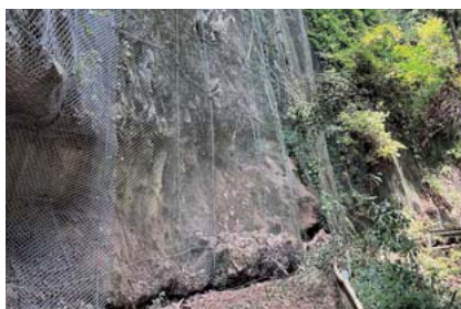
通行止めの津留線
