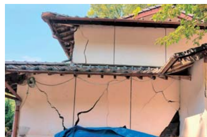
地震の影響により、外壁に亀裂が発生している様子
