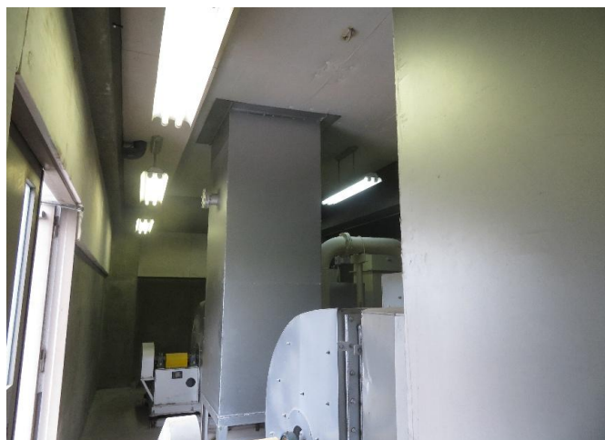
2F炉機械室
