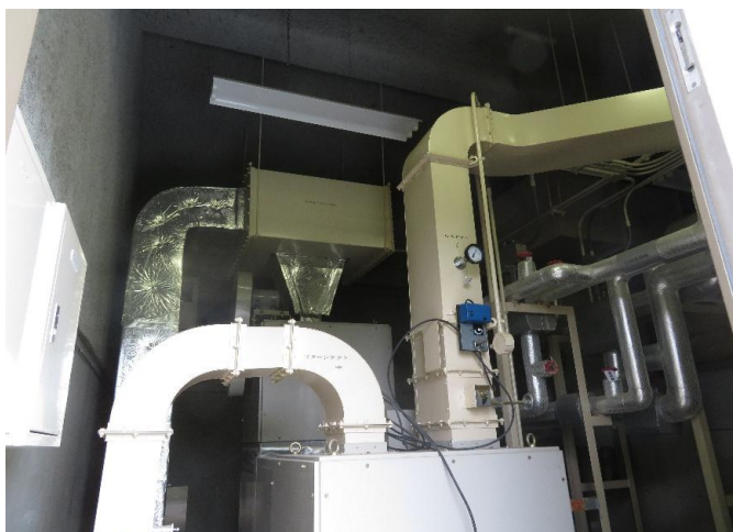
2F空調機械室
