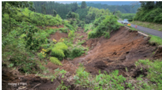
7月3日の豪雨災害の被災状況 （町道井無田川口線）
