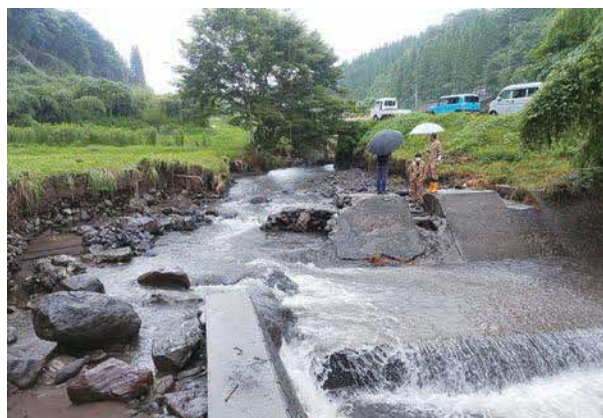
被害を受けた河川（頭首工）
