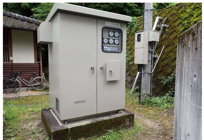
⑯ 泉源制御盤
