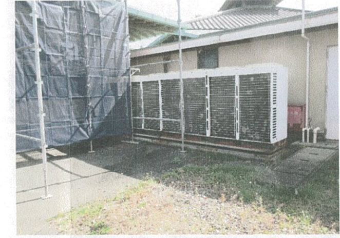
室外機置場 (西側)
