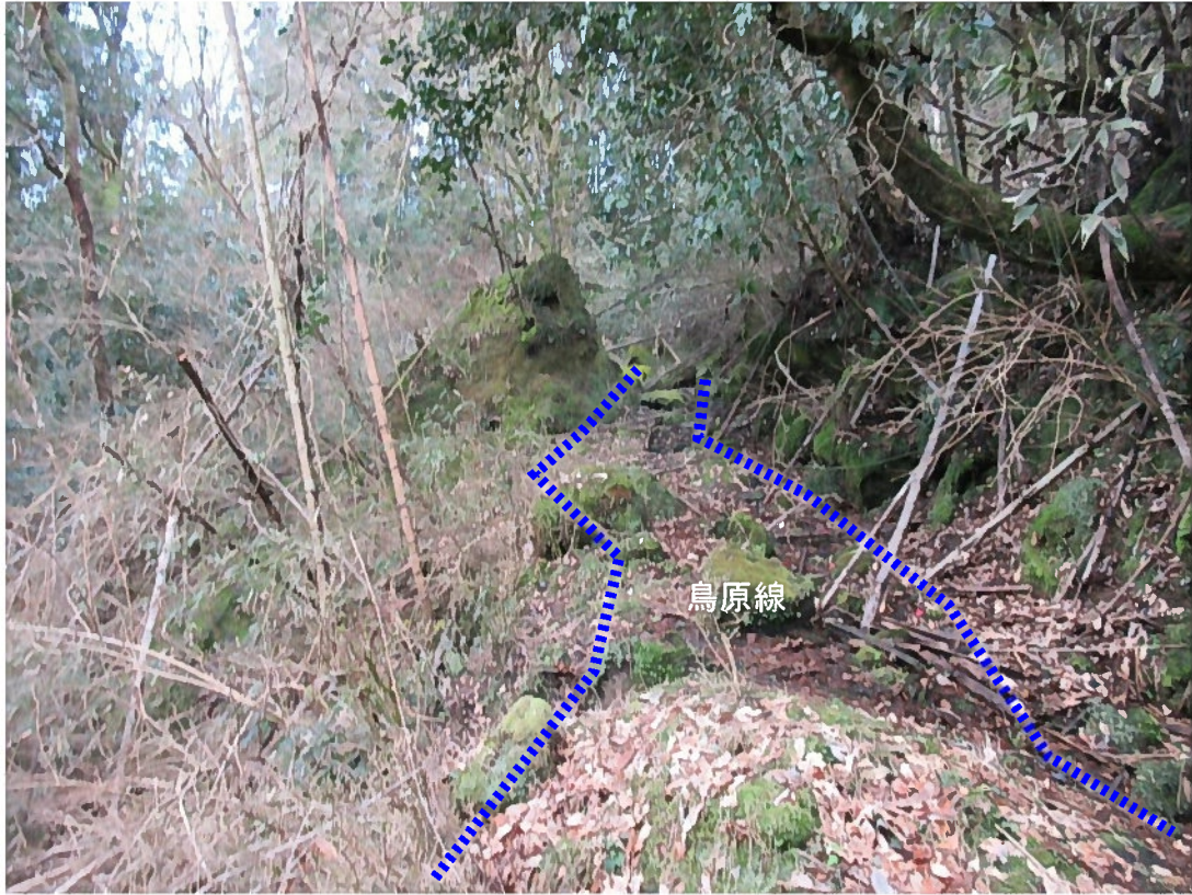
鳥原線の現況写真（路線機能の喪失状況）
