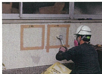
2. 数時間後、ヘラを使用し削り取る (溶剤が浸透しているため飛散することはありません)
