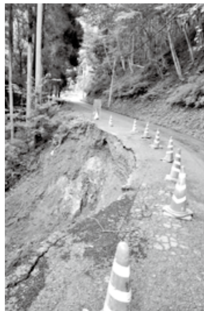
緑川の町道崩落現場
