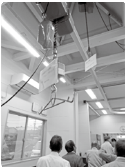
処理加工施設の内部
