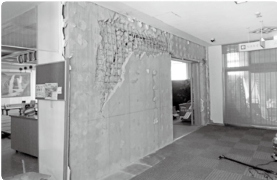
▲通潤山荘 崩壊した壁
