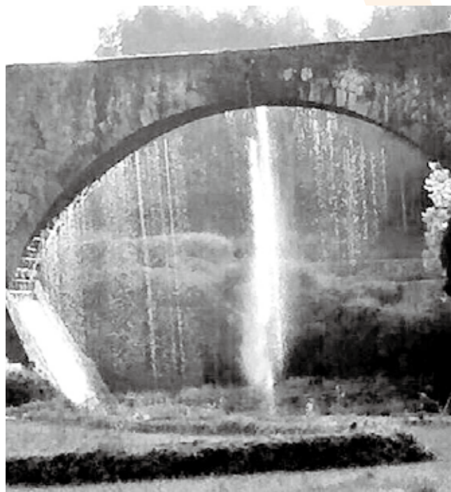
通潤橋は本震後大量の漏水が見られた
