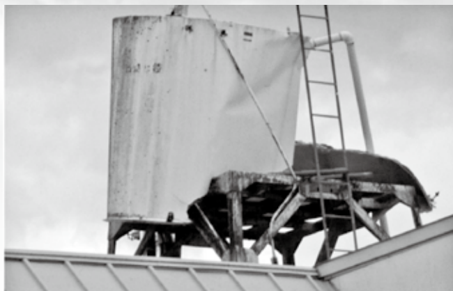
浜美荘屋上タンクが破損
