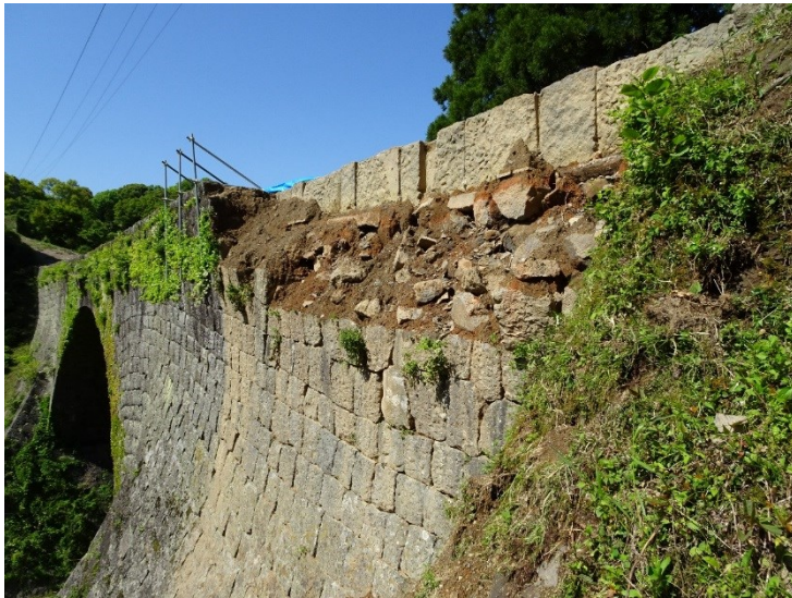
写真1 壁石垣崩落后 側面
