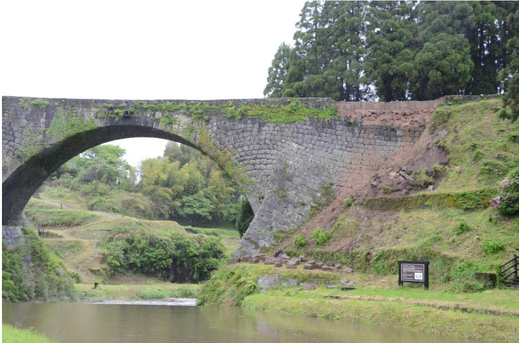
写真5 壁石垣 一部崩落直後（平成30年5月7日）
