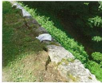
写真② 橋上端にある石材(通称：手摺石)が外側へせり出した状況
