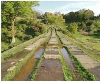
写真① 通潤橋上の漏水状況
