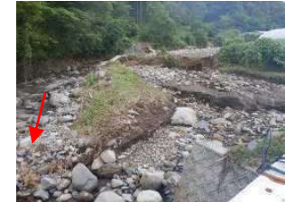
㊷ 溢水及び侵食による護岸崩壊
