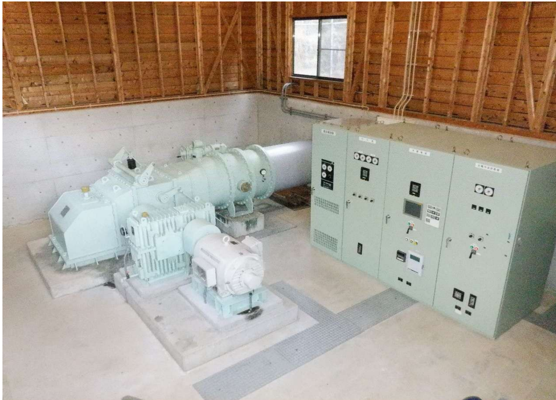
④建屋内部（水車、発電機、制御盤）
